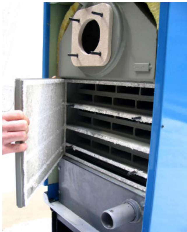
Bild 3-9: Revisionsklappe abnehmen zur Inspektion des Primär-Wärmetauschers.
