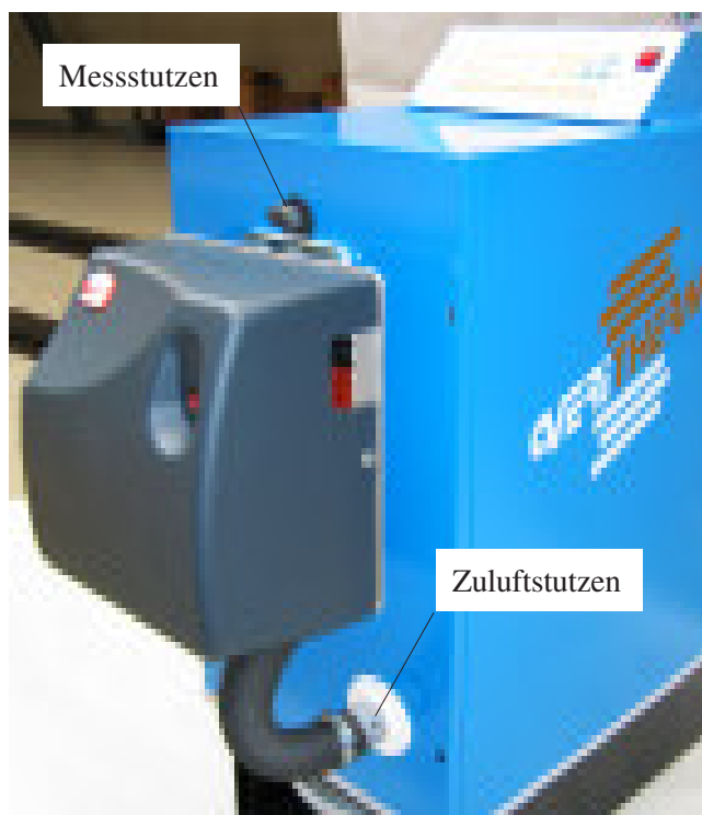
Bild 3-3: Messstutzen, u.a. für CO 2 -, Unterdruck-, NO x -Messungen usw., mit separatem Messgerät und zusätzlicher Messlanze in der Brennkammer sowie Messung der Verbrennungslufttemperatur am Zuluftstutzen.
