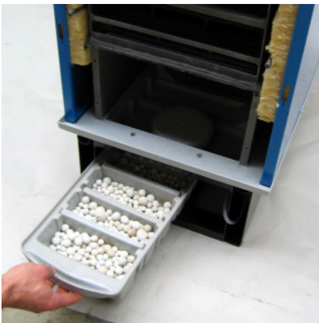
Bild 3-15: Kontrollieren der Neutralisationsanlage mit Granulatfüllung.
